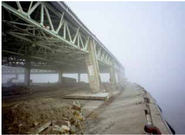
写真 2.6.5 岸壁のはらみ出し (境港市昭和町力二棧橋)
