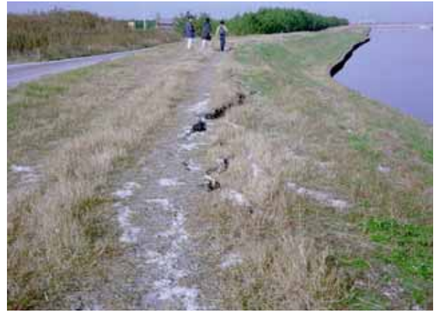
写真 2.6.4 護岸堤防のはらみ出し、堤体の亀裂、沈下 (米子市彦名新田)
