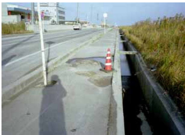
写真 2.6.7 マンホールの浮き上がり (境港市竹内団地)
