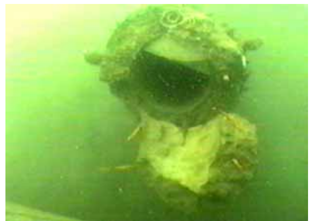
写真 2.6.8 杭式棧橋の水没(杭の破壊) (境港市公共マリナー) 境港管理組合のビデオテープより
