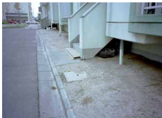
写真 2.6.1 共同団地周辺地盤の沈下 (米子市安部彦名団地)
