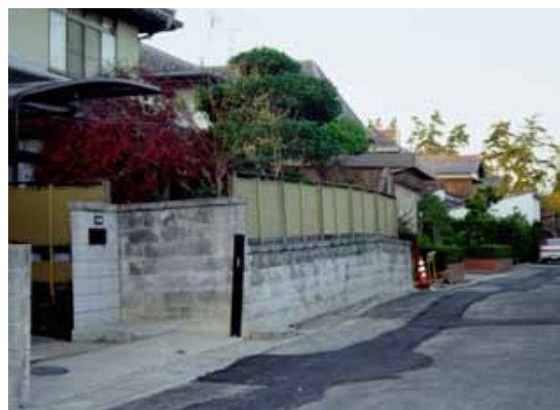
写真 2.6.2 戸建て住宅の沈下、傾斜 (米子市富益団地)
