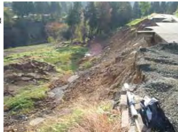
桂谷地区で見られる道路被害。徒歩による通行も困難な状態となっている。
