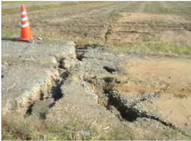
越路町西野(須川右岸側)の水田地帯に生じた地溝。周囲には噴砂が見られ、液状化によって地盤が沈下している。
