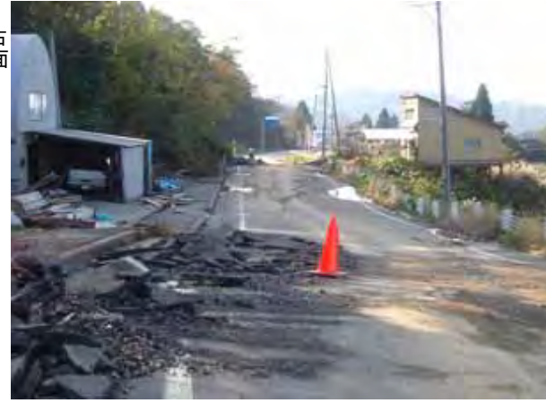
山古志村竹沢地区。 地すべりによって道路面に沈下が確認される。
