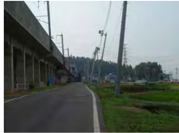
新幹線脱線現場付近の状況. 路面の波打ち, 電柱の傾斜等 の変状が見られる.
