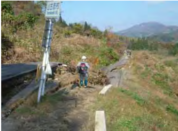
県道474号線の小千谷市と山古志村との境界部に見られる斜面崩壊。 写真奥は古志高原スキー場。
