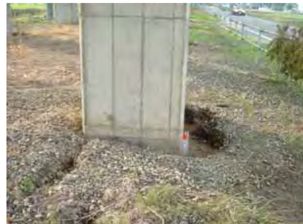
新幹線橋脚根入れ部に液状 化の痕跡が見られる.
