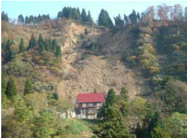
羽黒トンネル桂谷地区側の坑口南側斜面に発生した大規模な斜面崩壊。目測で、幅50～70m、斜面長が200m程度である。
