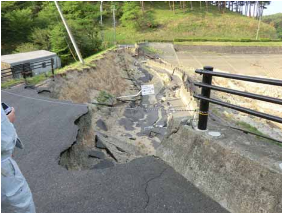
写真-5 副堤の円弧すべりの状況（頭部）
