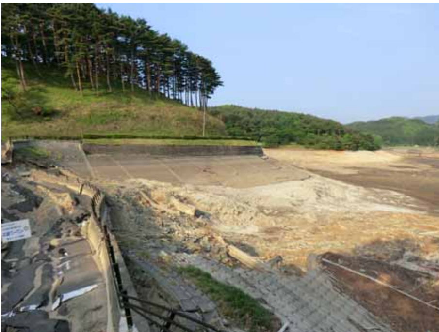
写真-6 副堤の円弧すべりの状況（末端部）
