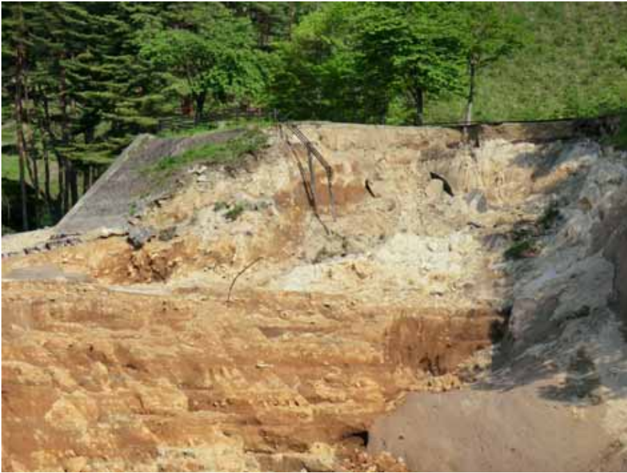
写真-3 残存している部分は褐色系統の粘土分を含む良好な土が丹念に締め固められている。上部は、白色の石英安山岩質の火砕流堆積物（溶結凝灰岩）起源の砂を多く含む。白色の砂は粘土分に乏しくボソボソしている。上部の施工は、巻きだしが不均質で締りが悪い。（左岸アバット部分を望む）。
