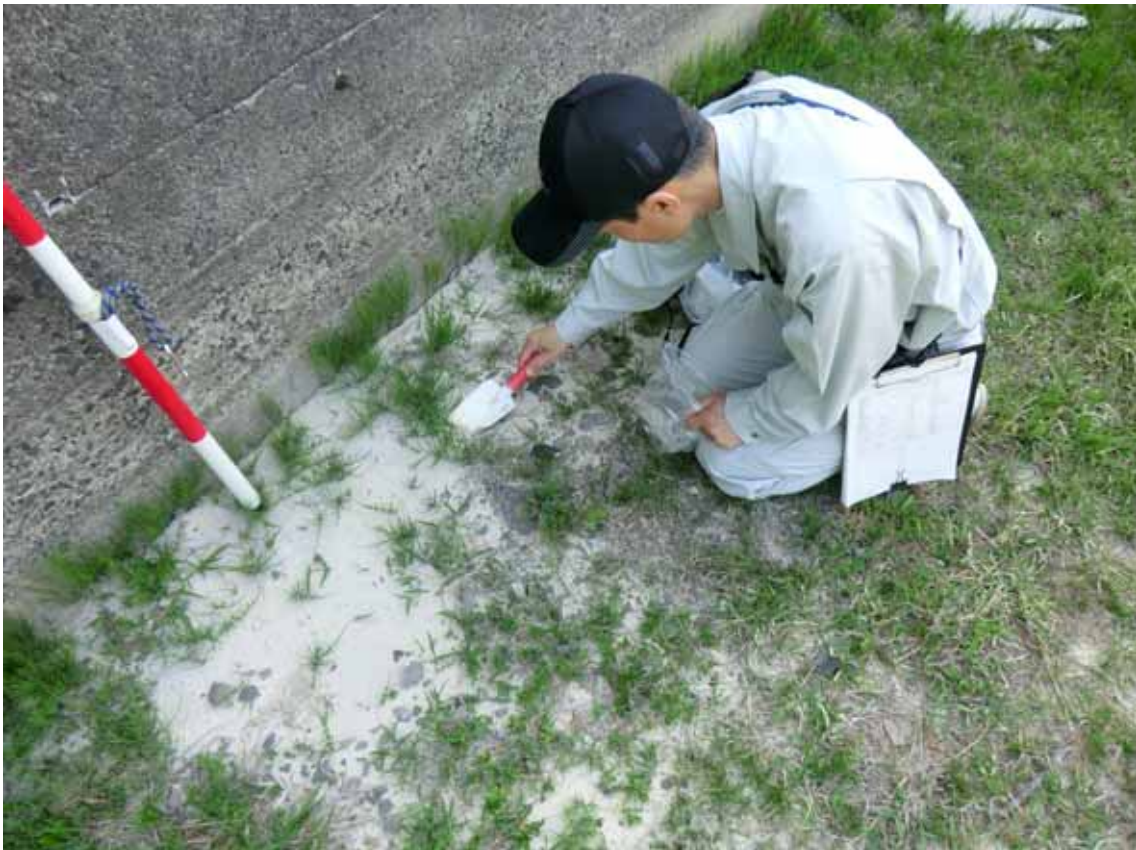
写真-5 左岸洪水吐付近にみられる噴砂
