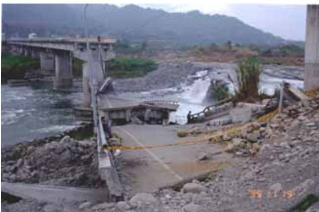
写真 - 3 被害全景(その3)
