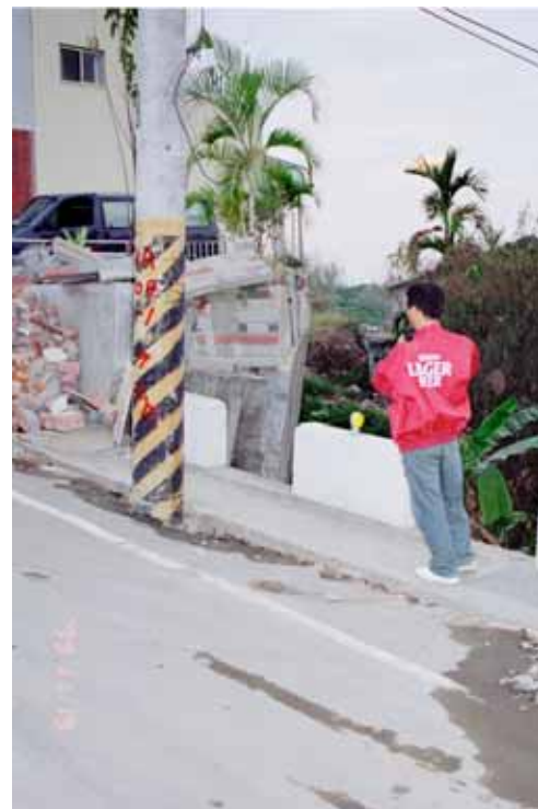
写真 - 8 傾斜した盛土擁壁
