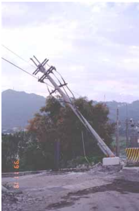
写真 - 7 根元で破壊した電柱
