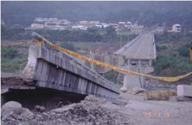
写真 - 1 被害全景(その1)
