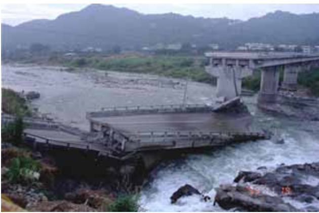
写真 - 2 被害全景(その2)
