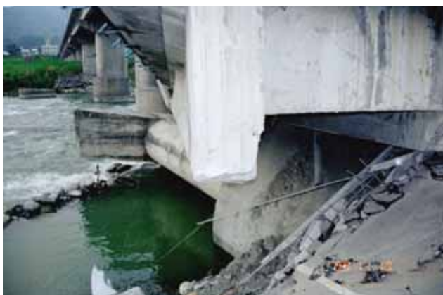
写真 - 4 倒壊した橋脚
