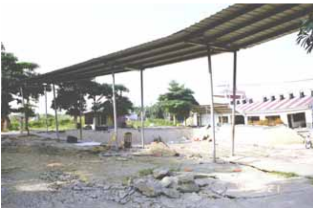
写真 - 7 周辺建物の被害状況 (その2)
