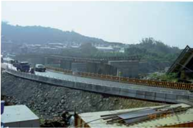
写真 - 1 被害全景
