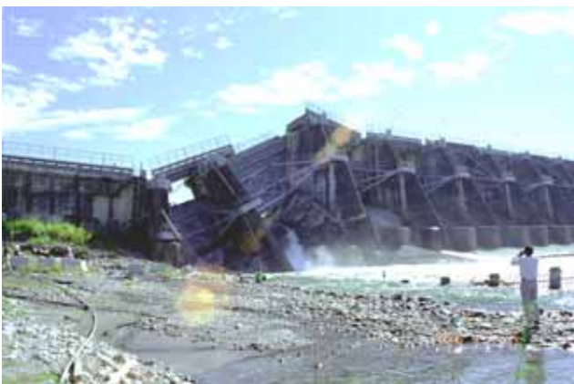
写真 - 2 ダム本体の被害状況 (その1)
