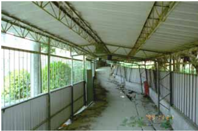
写真 - 9 地表地震断層による被害 渡り廊下にできた段差。
