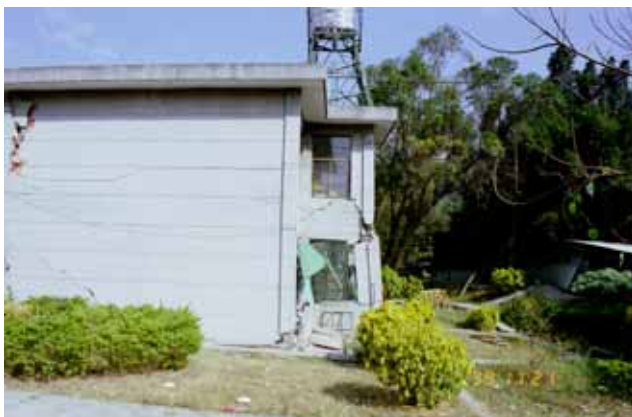
写真 - 11 建物の被害(その1)
