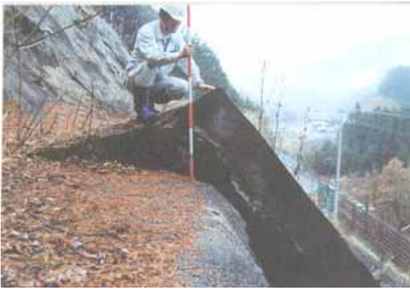
写真-3 のり枠の傾動
