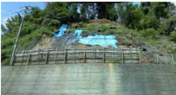
写真-1 表層崩壊の状況
