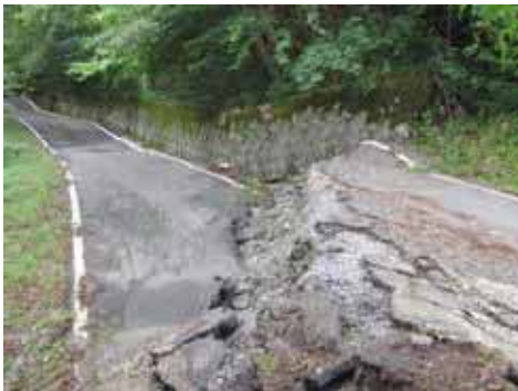
写真-1 地すべり災害による市道の沈下
