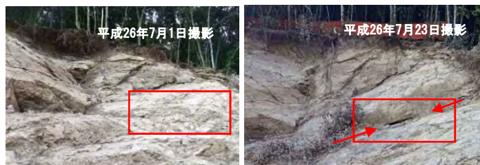
図-2 滑落崖に見られる開口亀裂の進展 左の写真に見られない開口亀裂が出現
