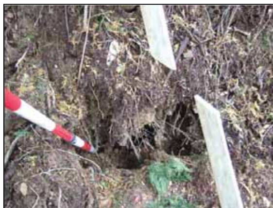
写真2 冠頭部の亀裂と抜板
