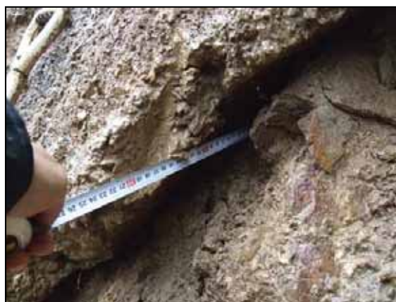
写真4 掘削面に生じた押出し
