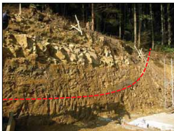
写真3 洪水吐掘削面と亀裂
