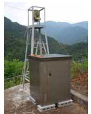
光波測距儀及びシステム格納庫 (自動視準・自動追尾トータルステーション)
