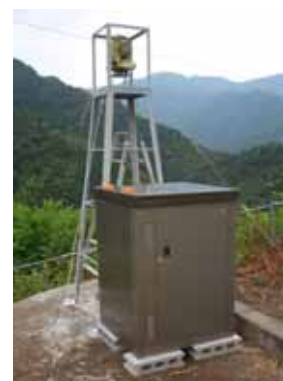
光波測距儀及びシステム格納庫 (自動視準・自動追尾トータルステーション)
